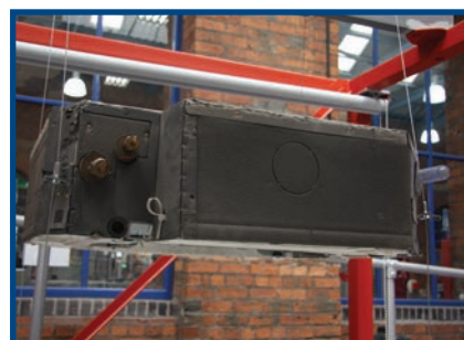
Unidad de aire acondicionado
