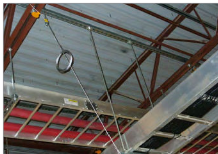
Arriostamiento de servicios eléctricos
